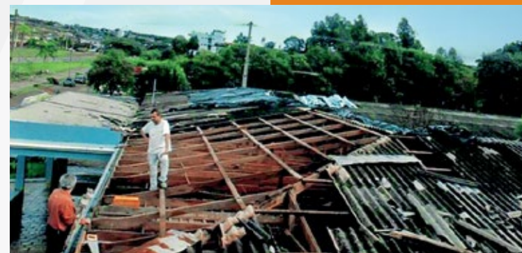
Hospital Santa Luzia, após o tornado.
